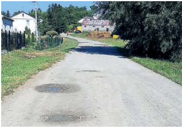
– Miał być asfalt, a znowu są dziury i kurz. Za rok, dwa z tej szutrowej podbudowy niewiele zostanie – skarżą się mieszkańcy Podhorzec.
