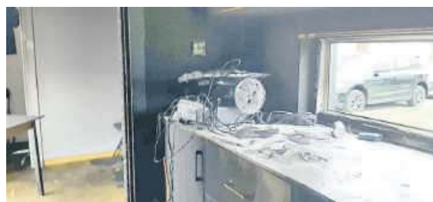
Spaliło się wyposażenie jednego z pomieszczeń kontenera: stół, krzesła, leżanka i komputer. Straty wstępnie oszacowano na 80 tys. zł.
