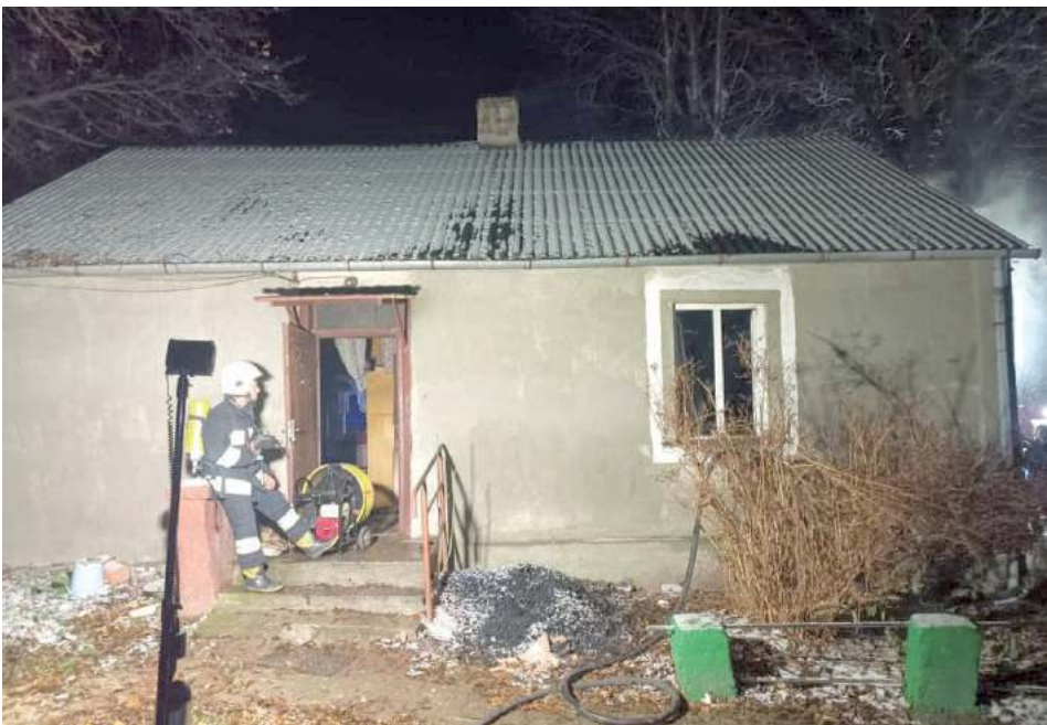
Co mogło być przyczyną pożaru? – Najprawdopodobniej doszło do zaproszenia ognia – przyznaje Robert Gruszecki, rzecznik prasowy Komendy Powiatowej PSP w Łęcznej
