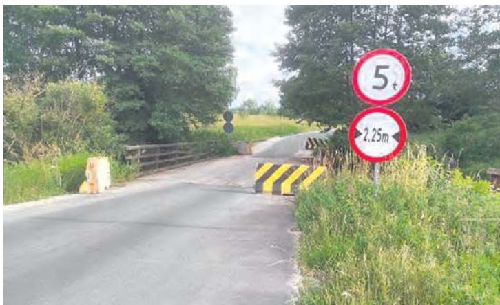
Most w Nadolniku. Stan budowli jest zły. Przebudowa to już konieczność.
