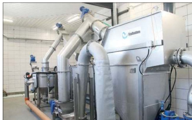
Urządzenia technologiczne oczyszczalni
