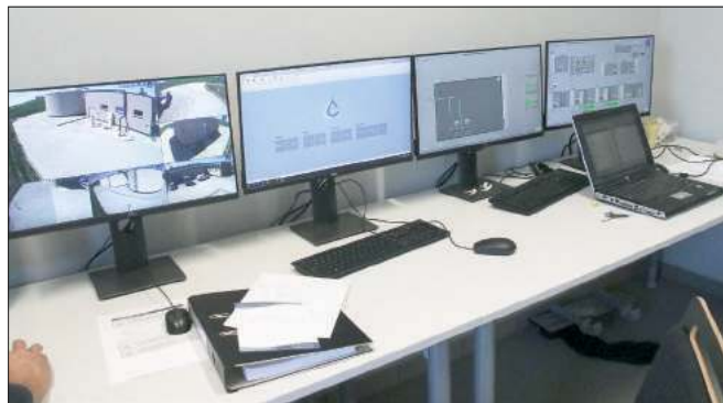
To „centrum dowodzenia” oczyszczalni
