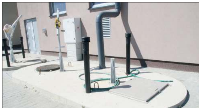
Część nieczystości będzie trafiała do oczyszczalni poprzez dowóz ich beczkowozem. Będą opróżniane w tym miejscu.
