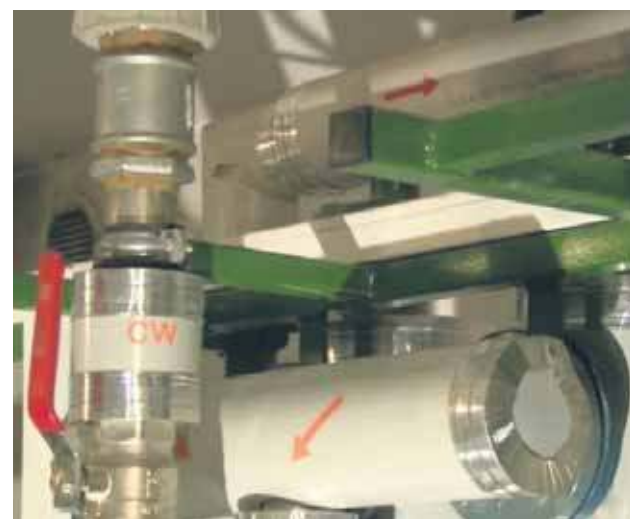
Czujniki kontrolują temperaturę na zewnątrz
