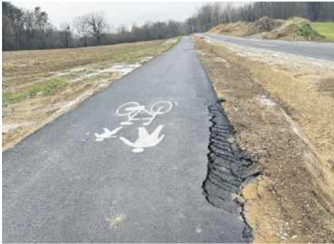
Tak wygląda zniszczona ścieżka rowerowa
