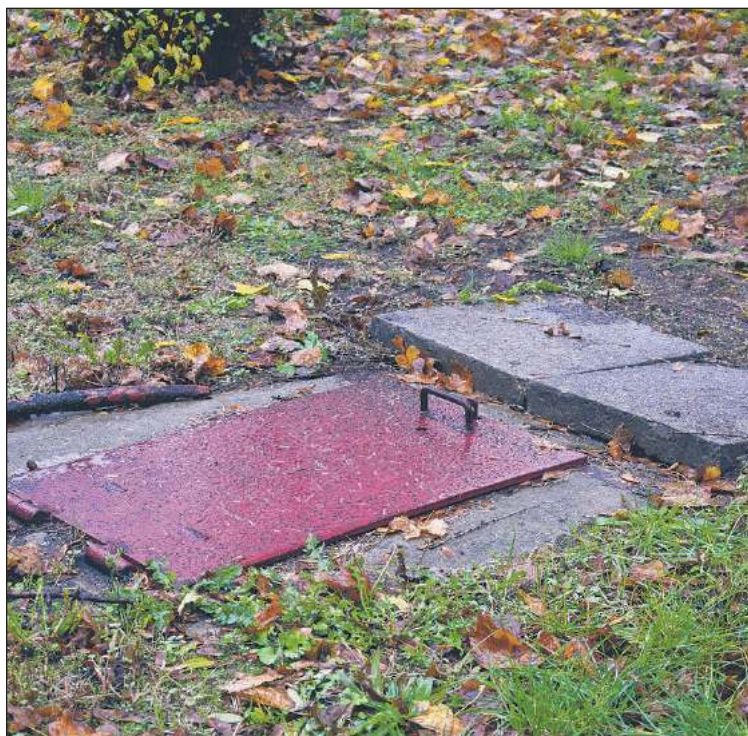
Zanim zareagowało Starostwo Powiatowe w Dębicy, zapadniętą studzienkę zabezpieczył mieszkaniec Dębicy.
