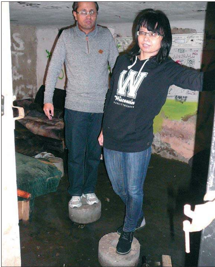
Monika i Tomasz Ciszowie są załamani tym, że od kilku dni w piwnicy ich bloku zalega warstwa śmierdzącego szlamu, którego ADM nie usunęło.
