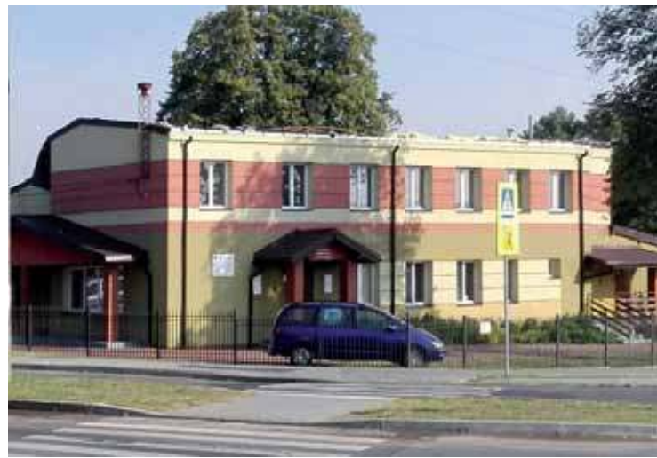
Uszkodzony dach świetlicy ma zostać naprawiony
