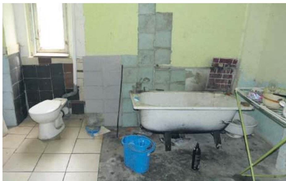
Tak wygląda łazienka. W kranie nie ma ciepłej wody, a pomieszczenie nie jest ogrzewane...
