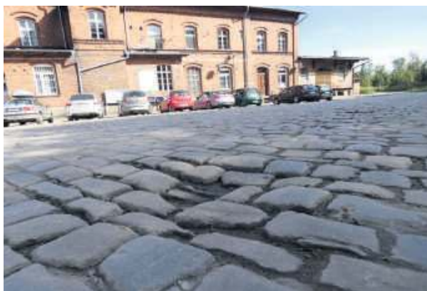
Nawierzchnia drogi na ul. Stacyjnej w Białym Kościele jest w fatalnym stanie
