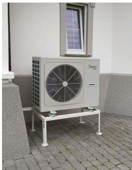
Z danych Centralnej Ewidencji Emisyjności Budynków wynika, że w Polsce pracuje już ponad 300 tys. pomp ciepła. ZYMETRIC
