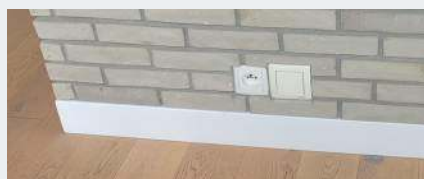
W dwukondygnacyjnym budynku zamontowano 4 gniazda.
