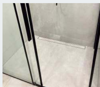
➊ Odpływ liniowy (80 cm) zamontowano pod natryskiem 120 × 90 cm.
