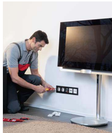
Kilka estetycznych gniazd może zastąpić płątaninę kabli. SCHNEIDER ELECTRIC
