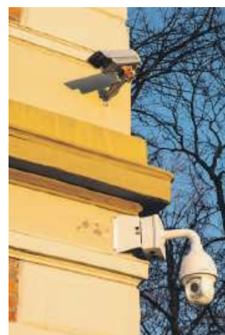
Kamery monitoringu na zewnątrz budynku dworca
