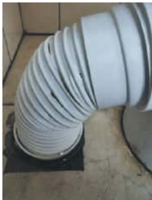
Notorycznie uszkodzany jest łącznik spustowy do kanalizacji
