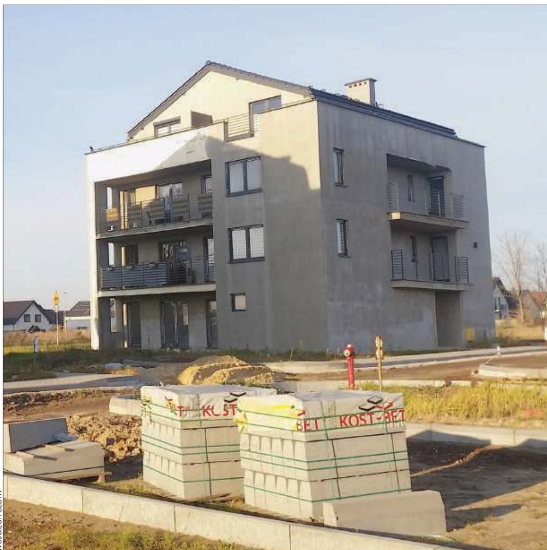
Na nowych blokach przy ul. Lawendowej 16-20 cieniem kładą się liczne budowlane braki, których uzupełnienie zdaniem mieszkańców będzie kosztowało 1,8 mln złotych.
