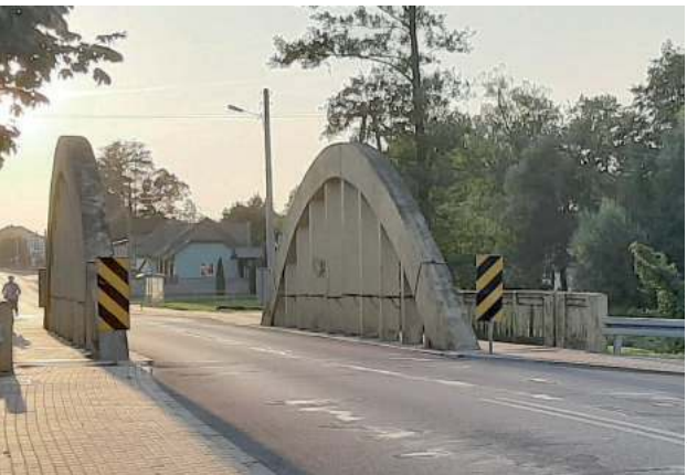
Most przy ul.Lubelskiej w Biłgoraju w końcu doczeka się modernizacji?
