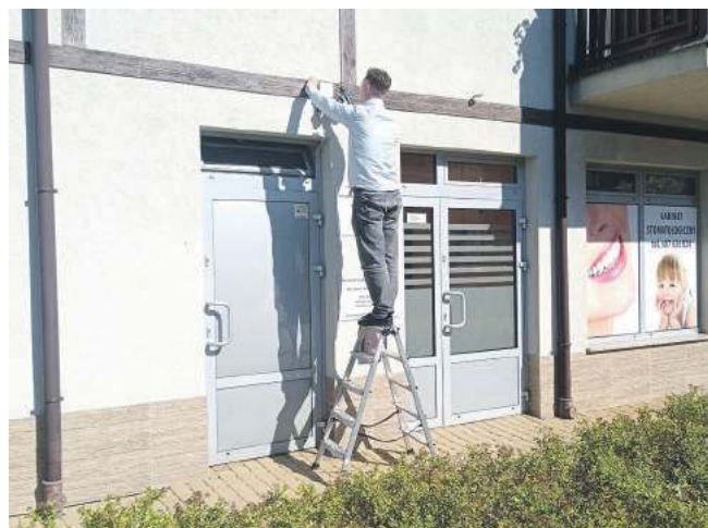
Montaż czujnika na ulicy Armii Krajowej w Trzebnicy
