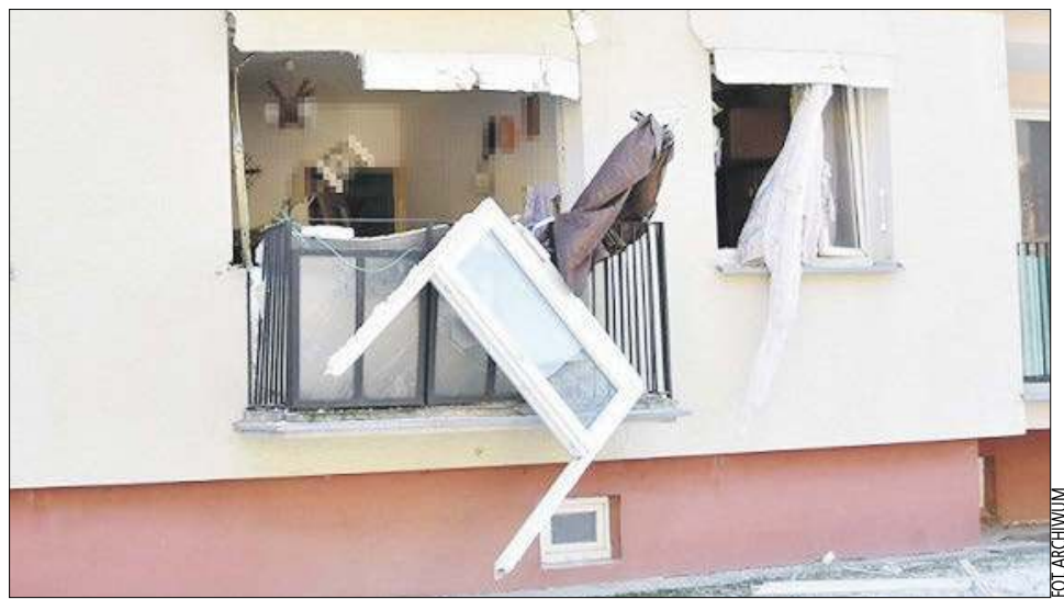
Z ustaleń inspektora nadzoru budowlanego wynika, że wybuch nie spowodował naruszenia konstrukcji budynku
