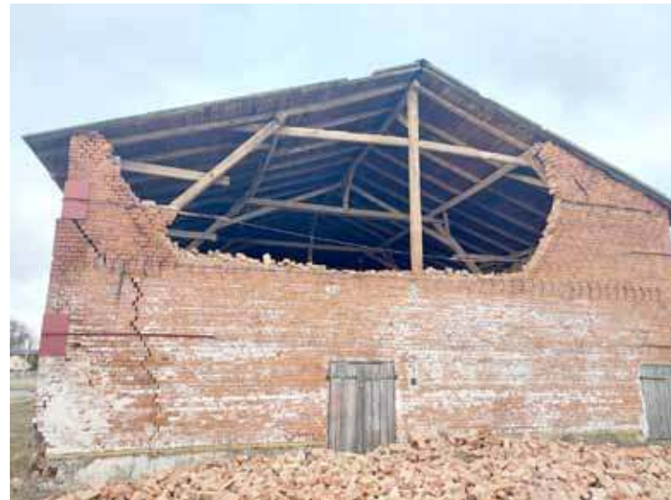
W Płoszkowie uszkodzona została ściana budynku gospodarczego. Foto. OSP. Dolice
