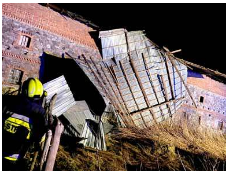
W miejscowości Wieleń wiatr uszkodził dach na budynku gospodarczym. Foto. OSP. Chociwel
