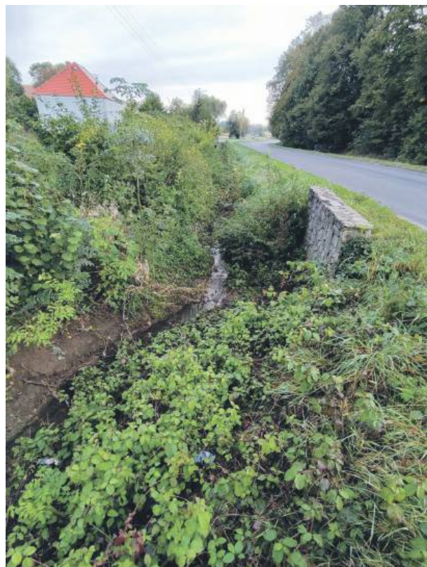
Niewyczyszczone i zarośnięte rowy w Dankowicach nie odprowadzają wystarczająco szybko wody po nawalnych deszczach
