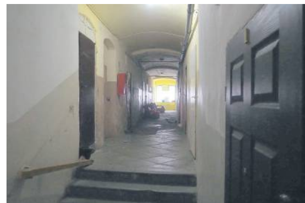
Obecnie w budynku na parterze mieszkają tylko cztery rodziny. Dziesiątki innych lokatorów dawno wysiedlono
