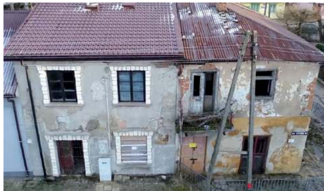
Kamienica przy Rynku II grozi zawaleniem
