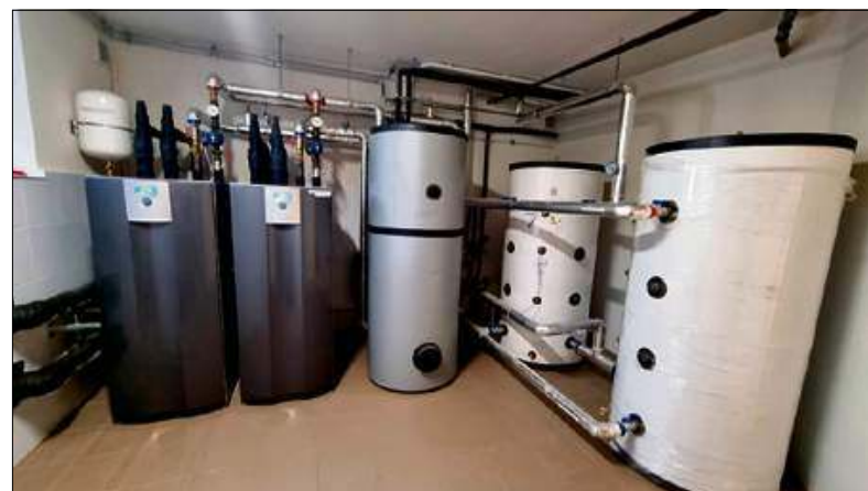
W szkole w Dębju zamontowano ekologiczną pompę ciepła. Dodatkowo na dachu budynku pojawiły się też panele fotowoltaiczne.
