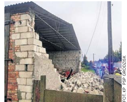
Pustaki z zawalonej ściany spadły na chodnik i ulicę
