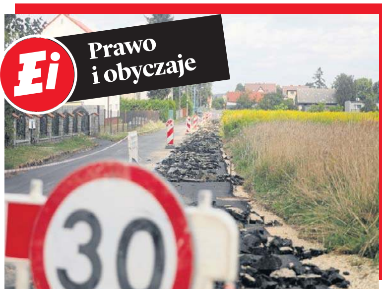
Droga przeorana przez ciągnik ma zostać naprawiona
