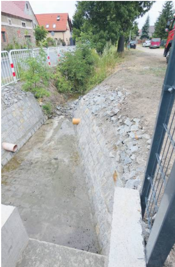
Tak wygląda odpływ z osadnika
