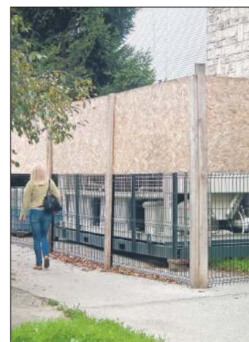
Agregaty zabezpieczono płytami.
