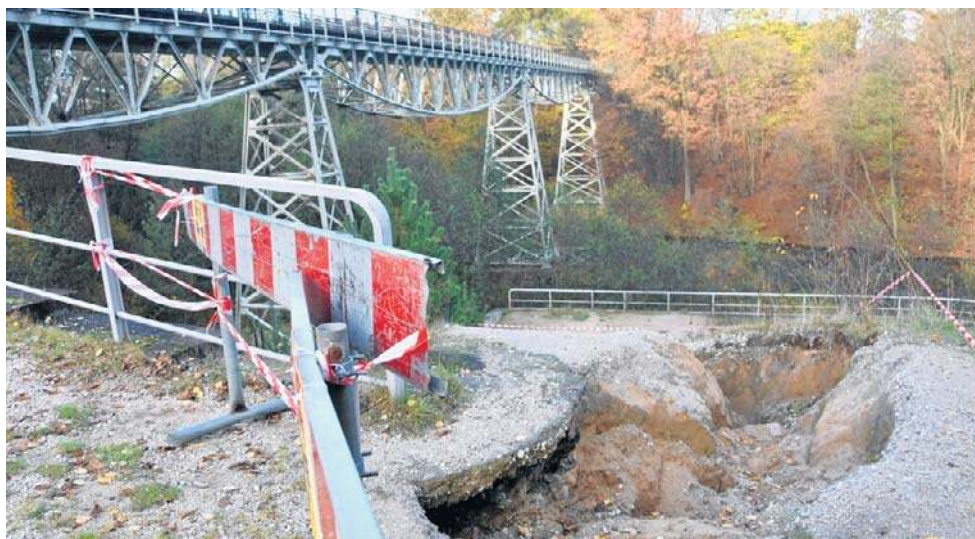
Przy moście kolejki wąskotorowej w Koronowie powstała ogromna wyrwa w ziemi ciągnąca się w dół aż do tarasu widokowego. Dla bezpieczeństwa postawiono barierki
