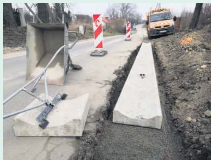
Kilkudziesięciometrowej długości koryto do odpływu wody rozwiąże problem na tym odcinku. Aby całkowicie wyeliminować niekontrolowane spływy wód, potrzebne jest przedłużenie tego pasa o przynajmniej kilkadziesiąt metrów w obu kierunkach
