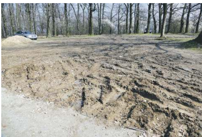
Obok ścieżki, w najwyższym jej punkcie, jest dużo błota. Parkują tam samochody. Warto utwardzić ten teren kruszywem i żwirem
