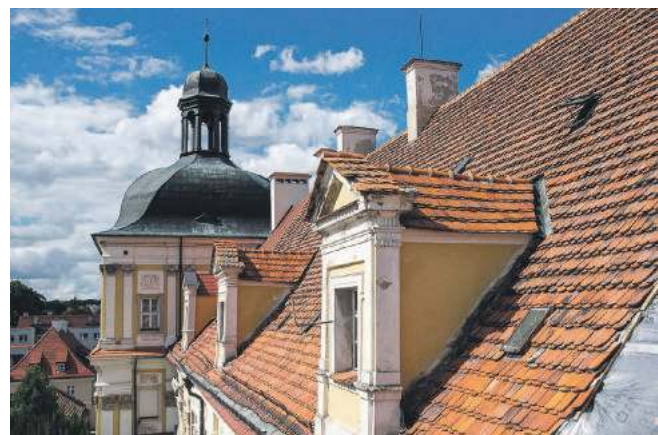
Do wyremontowania pozostała jeszcze część dachu wraz z wieżą
