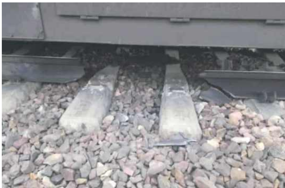
Wyrwa w torach miała ok. metra
