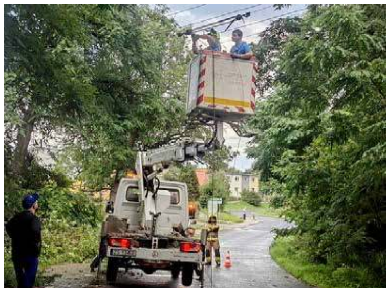
Przyjezierze ul. Moryńska. Zerwana linia energetyczna przez nadłamaną konar drzewa. foto. OSP Moryń
