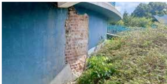
Ze ścian odpadła zewnętrzna warstwa, odsłaniając cegły
