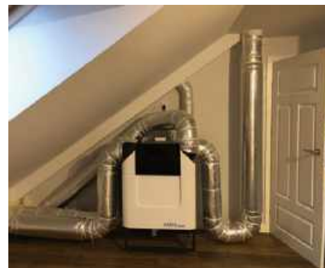
🔧 Nie mniej ważny niż sam rekuperator jest odpowiedni system kanałów. To ich ukrycie jest zwykle największym problemem w remontowanym domu. AERIS NEXT
