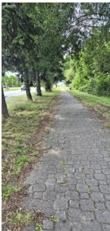
Chodnik wzdłuż ul. Marii Curie - Skłodowskiej przed remontem.
