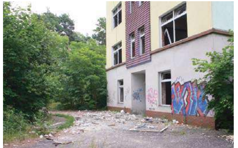
Po chwilowych nadziejach, że obiekt uda się doprowadzić do świetności, dziś jest na krawędzi ostatecznego upadku
