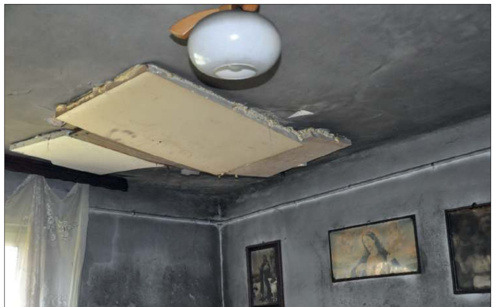
Sufit grozi zawaleniem.
