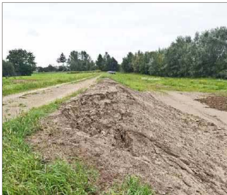
Ziemia zjeżdża na odcinku ok. 30 metrów. To jednak grozi przerwaniem wału na znacznie dłuższym odcinku.
