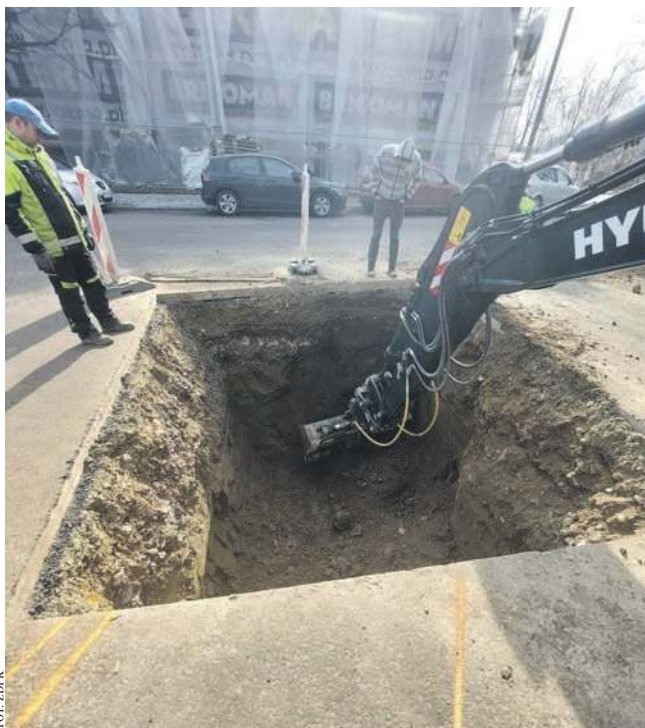
Podczas kontroli zapadliska odkryto głęboki kanał
