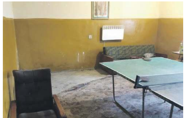
Tak wyglądało pomieszczenie w świetlicy przed remontem
