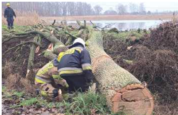
W Samoklęskach Kolonii padające drzewo zerwało linię energetyczną
