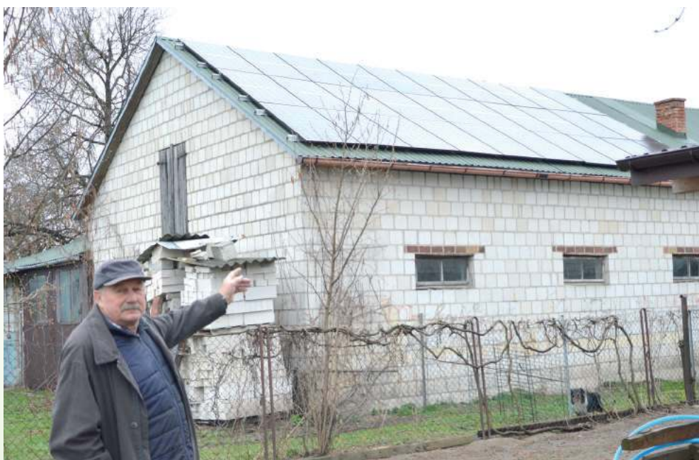
- Już drugi rok prąd w ogóle nic mnie nie kosztuje. Wcześniej za prąd rocznie płaciłem około 6 tys. zł - wylicza Marian Starownik, pokazując swoje panele fotowoltaiczne zamontowane na dachu budynku gospodarczego
