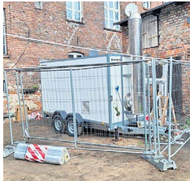
Ciepło pochodzi z kotłowni olejowej, która została tymczasowo zainstalowana na podwórku
