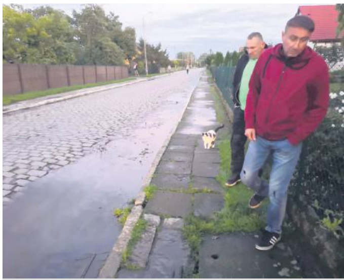
Sołtys Radosław Mosoń (na pierwszym planie) od długiego czasu zabiega o naprawę kanalizacji deszczowej w Witowicach. Na zdjęciu widać, jak wypływająca ze studzienki brudna woda płynie drogą w dół wsi
