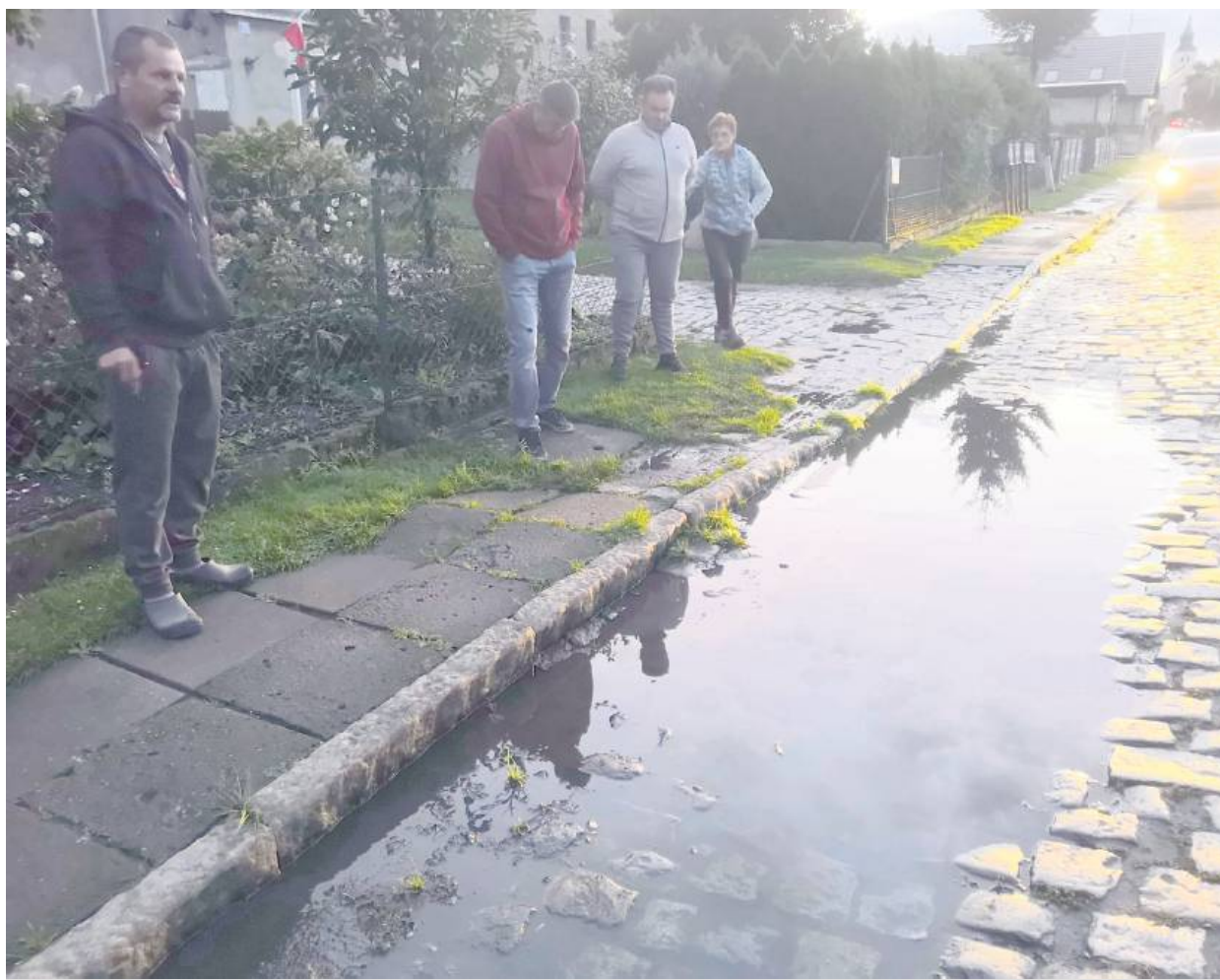
Mieszkańcy, z którymi się spotkaliśmy, stoją przed kratką, skąd wybijają ścieki i płyną dalej drogą w dół miejscowości
