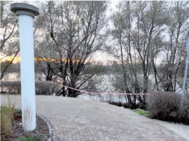
Drewniane elementy konstrukcji przez lata zepsuły się pod wpływem wilgoci, jednak betonowe fundamenty są w dobrym stanie. W przyszłym roku prawdopodobnie pojawią się tu nowe schodki, tym razem z bardziej odpornego materiału
