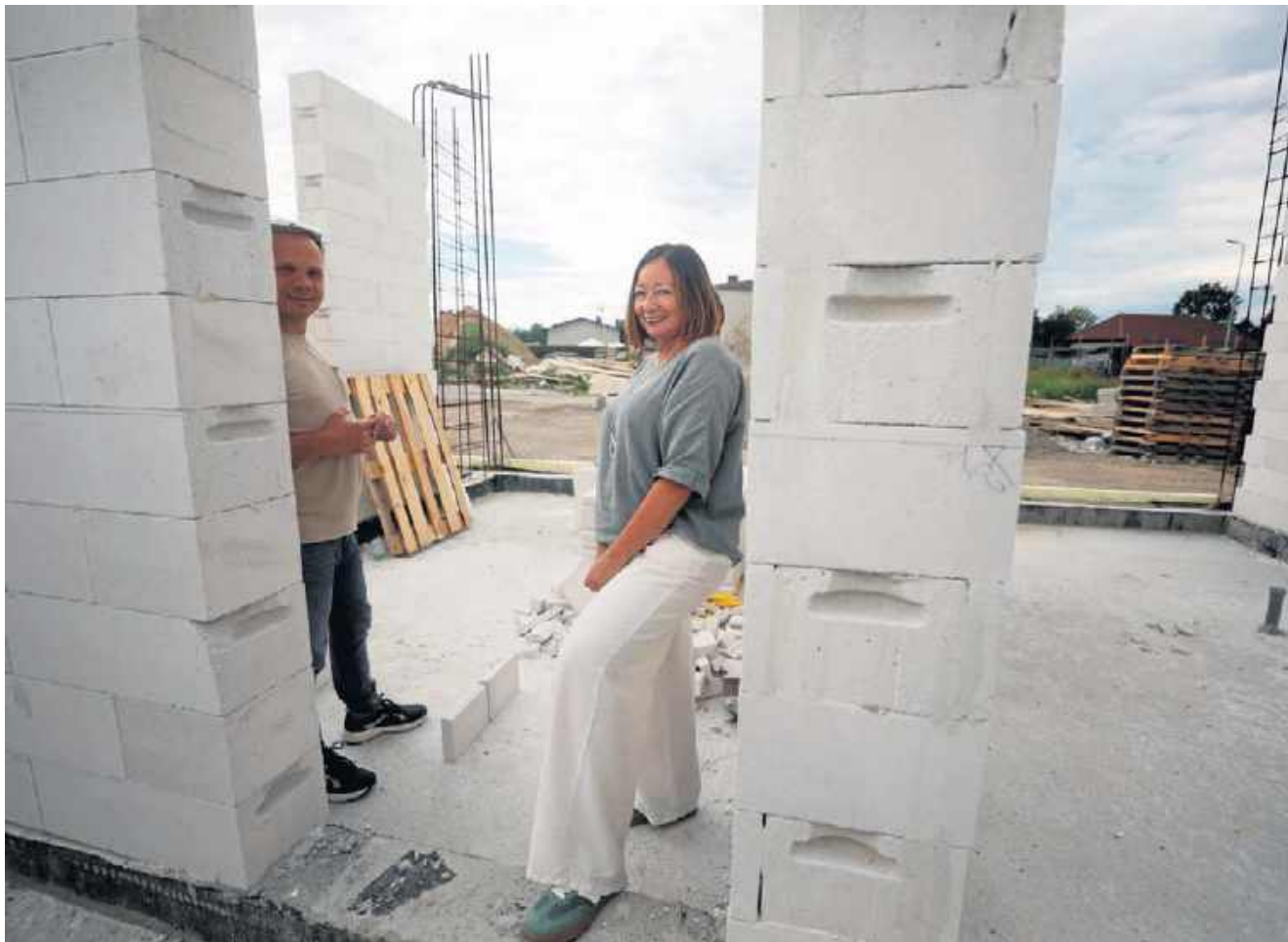
Prace budowlane rozpoczęły się na przełomie listopada i grudnia. Trwa wznoszenie ścian
