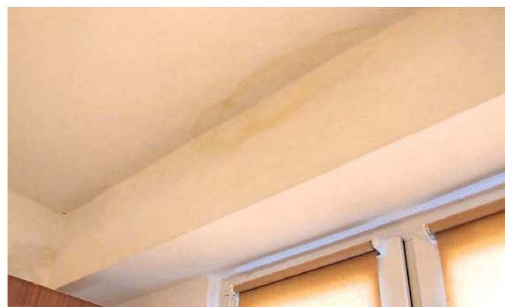
Problem z zalewaniem w mieszkaniu położonym na ostatnim piętrze bloku jest także w kuchni.
