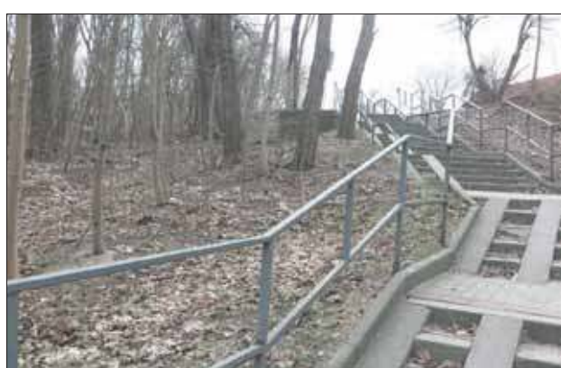
Miejsce jest niebezpieczne dla przechodniów
