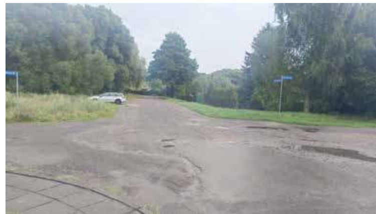
Asfalt na jezdni kończy się, zastąpiony ziemią
