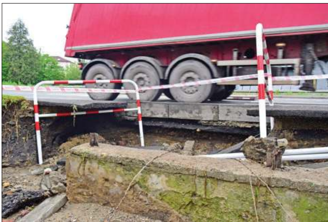
Uszkodzony chodnik przy ul. Bukowskiej w Syryni
