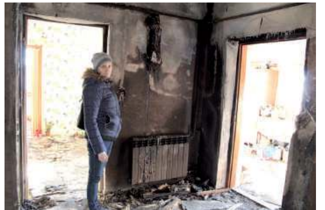
Pożar zniszczył cały strych, konstrukcję dachu i część pomieszczeń mieszkalnych
