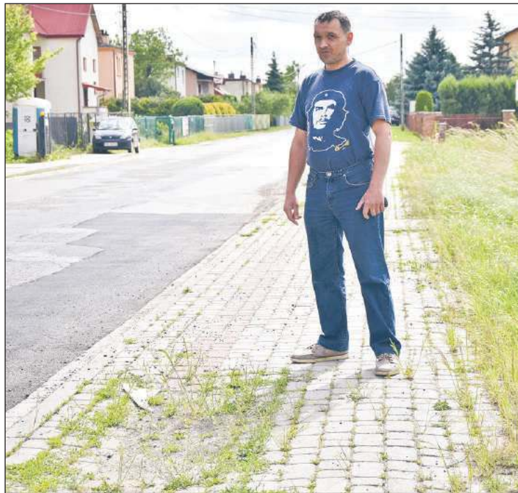
Tak wygląda chodnik na przystanku autobusowym, na którym wysiadają uczestnicy zajęć Domu Dziennego Pobytu w Dębicy.
