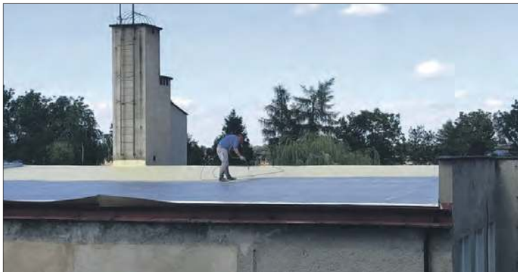
Dach nad GOK-em w Lubrzy „wygląda nieźle”
